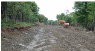
Photo 1 : Fossé de forme parabolique. Pratique exemplaire avec un fond suffisamment large pour éviter l'écoulement concentré et avec des pentes de talus stables.
